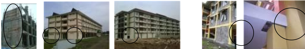
(a) Pemasangan dinding geser di lantai dasar (b) Perbaikan rusuna Yogyakarta Gambar 12 Perbaikan dan Peningkatan Desain
