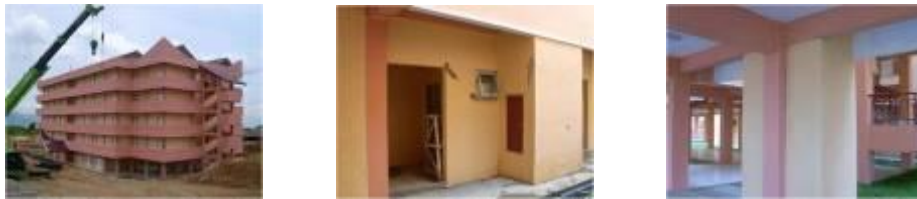
(a) Gempa 6 Maret 2007, ada kerusakan arsitektur di lantai dasar namun tidak ada kerusakan struktur
