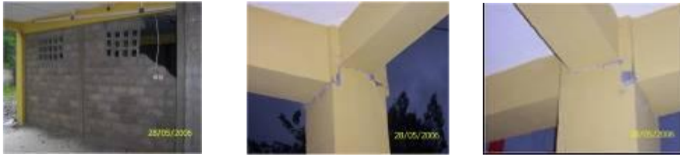
Gambar 9 Rumah Susun Sederhana dengan Sistem Pracetak yang Terkena Gempa Yogyakarta (2006)
