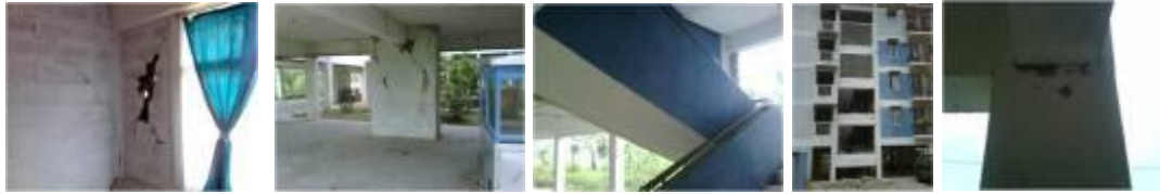
Gambar 10b Kerusakan tipikal pada 4 blok yang dibangun 2004 dan 2007
