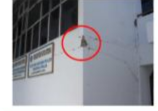
Retakan di gedung Pemerintah Bitung
