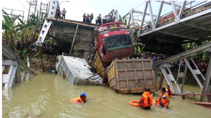
Petugas mengevakuasi truk di lokasi jembatan Widang yang runtuh, Tuban, Jawa Timur, Selasa (17/4).
