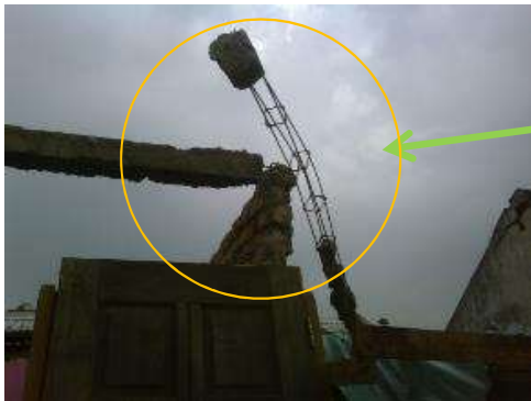
Sambungan tidak saling mengkait
