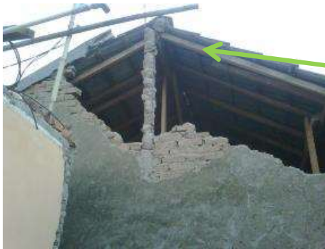
Tidak ada ring balok di sopi-sopi
