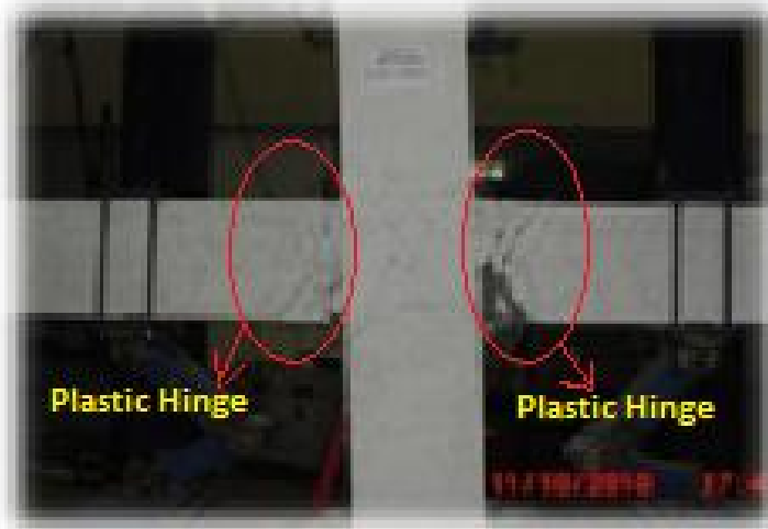
Kerusakan di balok (sulit diperbaiki)
