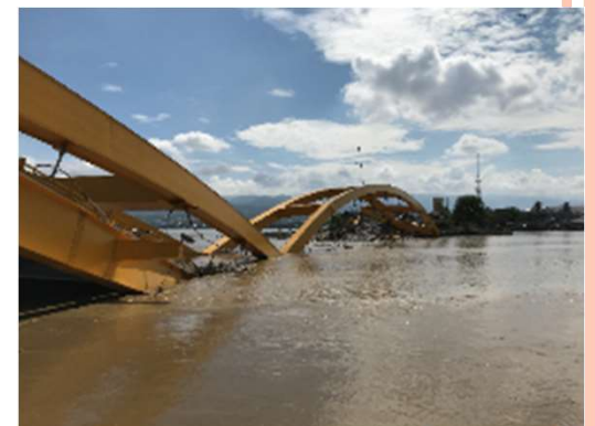
Bangunan Jembatan Rubuh
