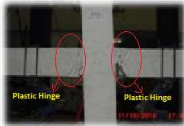
Kerusakan di balok (sulit diperbaiki)
