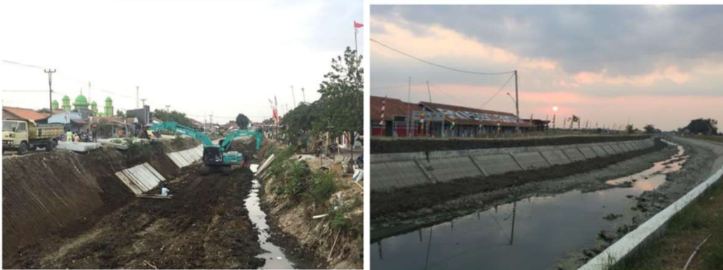
Gambar Pemasangan Panel DI. Pemali-Brebes
