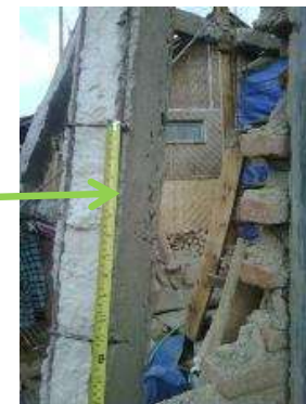
Dimensi tulangan kolom dan jarak sengkang tidak memenuhi syarat
