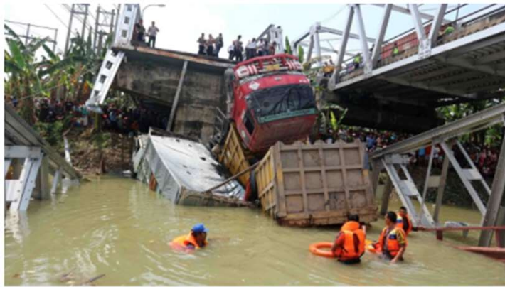
Pelugas mengevakuasi truk di lokasi jembatan Widang yang runtuh, Tuban, Jawa Timur, Selasa (17/4).
