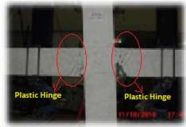
Kerusakan di balok (sulit diperbaiki)
