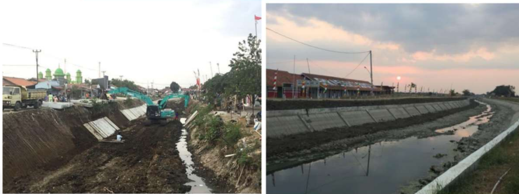
Gambar Pemasangan Panel DI. Pemali-Brebes
