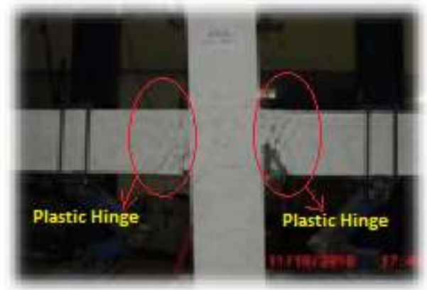
Kerusakan di balok (sulit diperbaiki)
