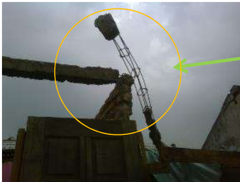
Sambungan tidak saling mengkait
