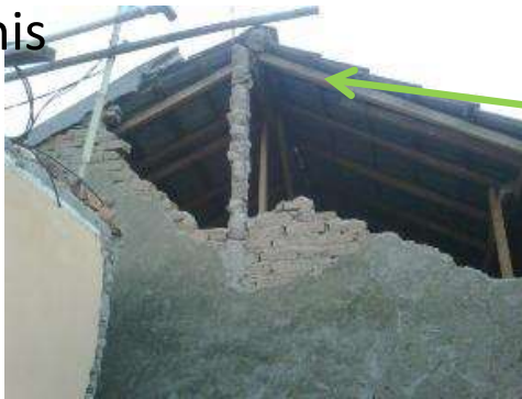
Tidak ada ring balok di sopi-sopi
