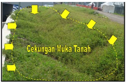
Foto 2. Kondisi cekungan permukaan tanah (top soil) pada belakang dinding/ panel beton RW
