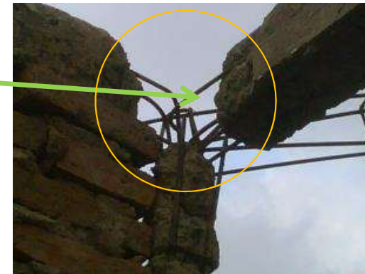
Sambungan tidak saling mengkait
