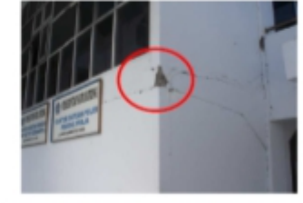
Retakan di gedung Pemerintah Bitung
