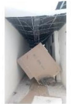
Plafon pada lantai 2 sebagian jebol
