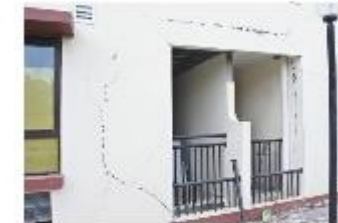
Retak signifikan pada setiap lantai
