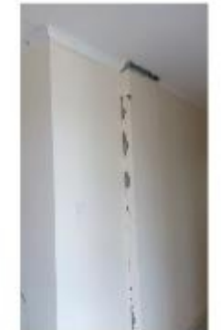
Retakan pada pertemuan antara dinding dan kolom meluber
