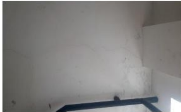
Keretakan pada area tangga
