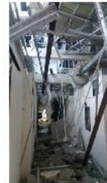
Plafon pada rooftop jebol
