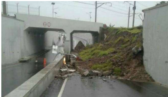
Underpass Soetta Salah Desain, Menteri Basuki Instruksikan Dibongkar
