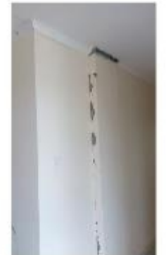
Retakan pada pertemuan antara dinding dan kolom meluber
