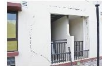
Retak signifikan pada setiap lantai
