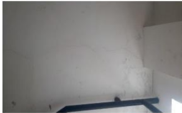
Keretakan pada area tangga
