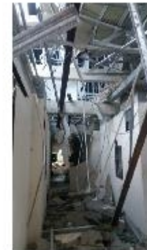
Plafon pada rooftop jebol
