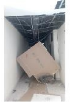
Plafon pada lantai 2 sebagian jebol
