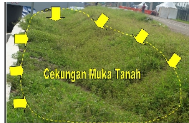
Foto 6. Kondisi cekungan permukaan tanah (top soil) pada belakang dinding panel beton RW
