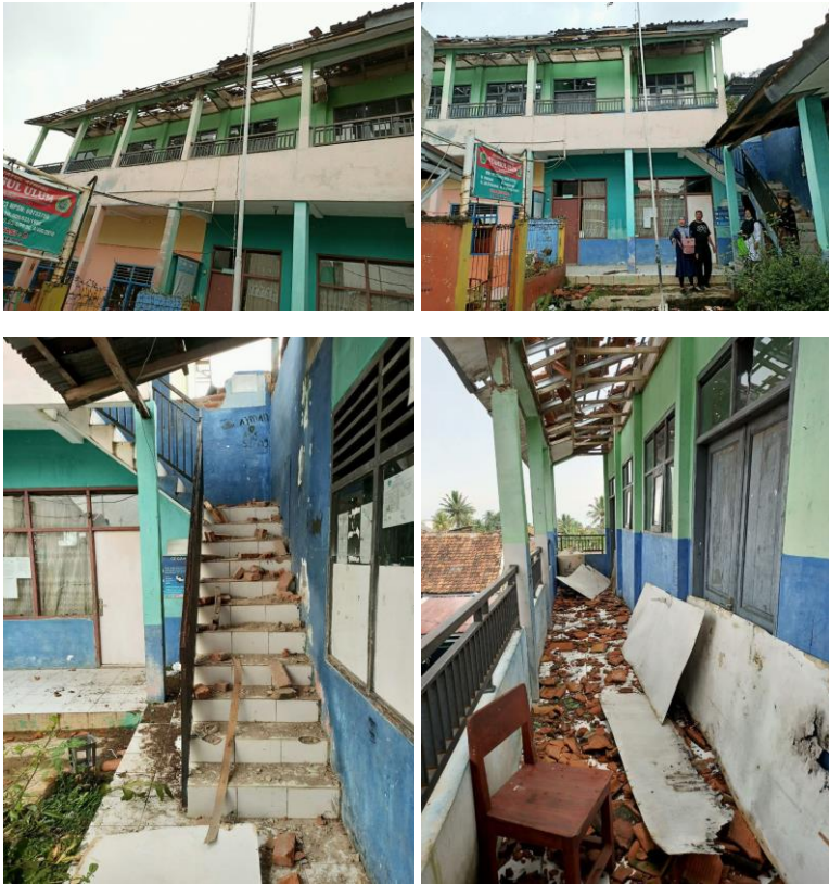
Gambar 8.1 Kondisi Sekolah Setelah Gempa
