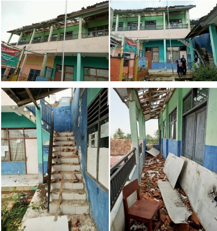
Gambar 8.1 Kondisi Sekolah Setelah Gempa
