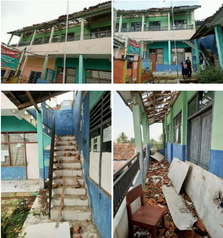
Gambar 8.1 Kondisi Sekolah Setelah Gempa
