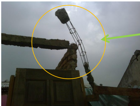
Sambungan tidak saling mengkait
