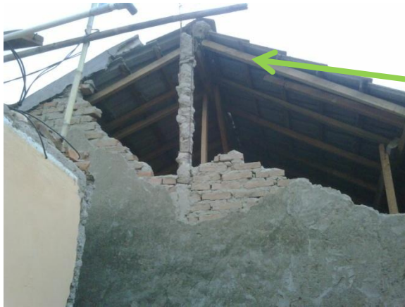
Tidak ada ring balok di sopi-sopi
