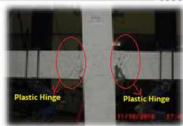
Kerusakan di balok (sulit diperbaiki)
