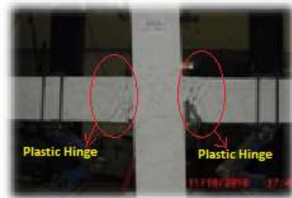
Kerusakan di balok (sulit diperbaiki)
