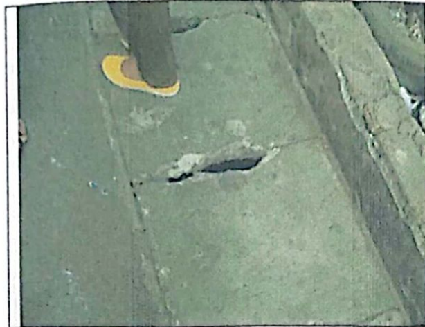
Gambar 4: Tipologi kondisi jalan lingkungan masyarakat Kelurahan Paseban, sudah mempergunakan Perkerasan Beton. (Sumber: dokumentasi Peneliti)
